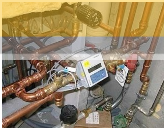
یک نمونه اندازه گیر گرما نصب شده در موتورخانه
